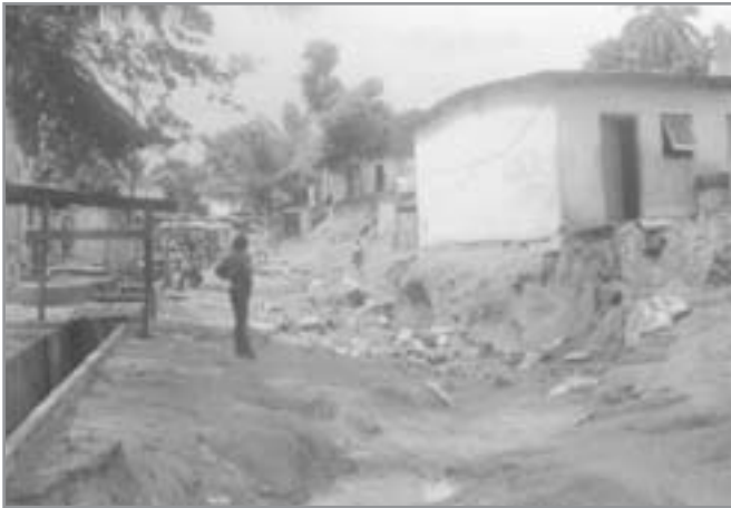
Photo 4.1 : L'action de l'érosion au pied d'une maison dans l'habitat précaire (Attécoubé)
